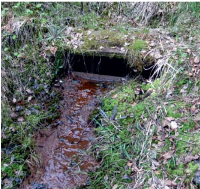
Utfällning av järnhydroxider nedanför hälsokällan
